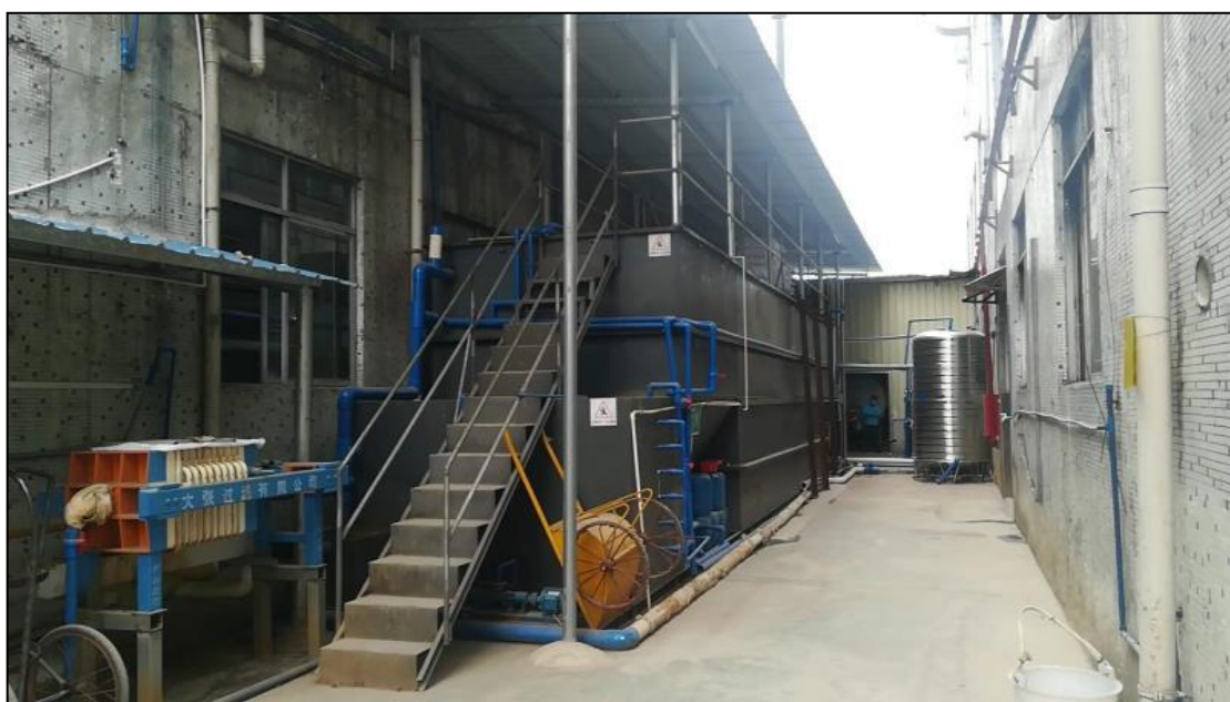
附图3.2-5 污水站建设现状图
