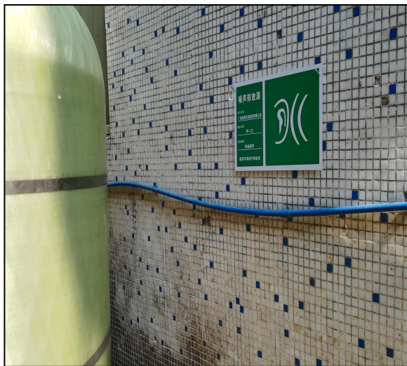
照片 9.3-3-空压机房
