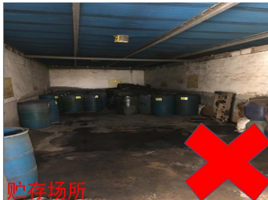
易燃易爆危废不设 导流沟、应急池、消防设备等
